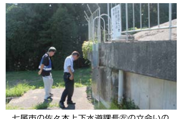
七尾市の佐々木上下水道課長との立会いの下、中島配水池の状態確認に臨む宮島名譽教授
